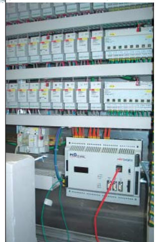
Bild 3: Lösungen der komplexen Steuer- und Regelaufgaben mit der Kombination Saia SPS PCD2 und EIB-Komponenten. (Quelle: BUS-House)
