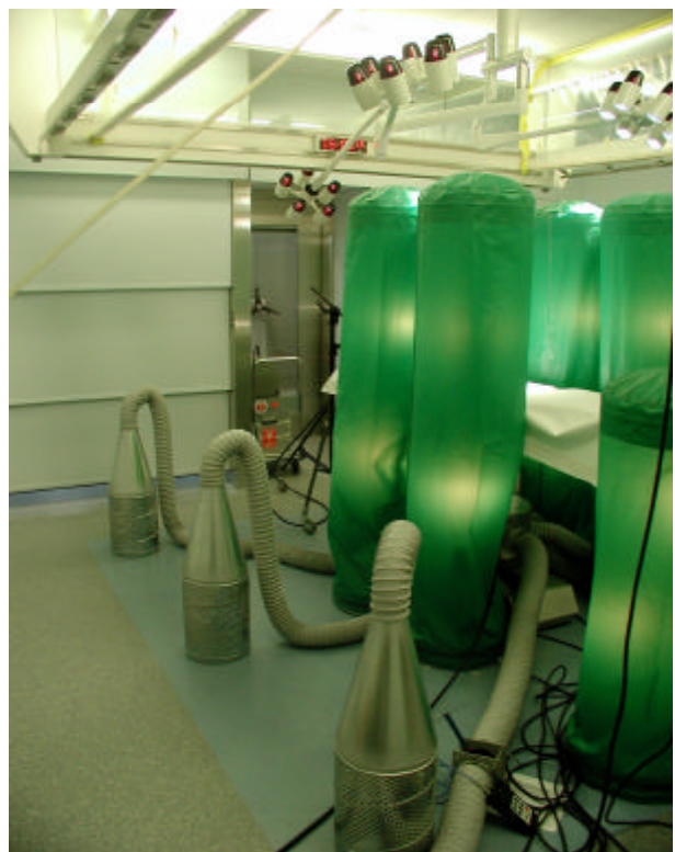
Musterlastanordnung: OP-Qualifizierung GZO-Spital Wetzikon. Unter dem OP-Tisch ist der Verteiler für die Referenzlast sichtbar. Die Luftprobe für die Messung der Partikelkonzentration wird diesem Verteiler entnommen. Im Vordergrund die Luftgeschwindigkeitsmessung zur Ermittlung des Volumenstroms. Diese Aufnahme wurde im Rahmen einer Diplomarbeit gemacht. Es galt den Einfluss verschiedener Auslassgrößen auf den Schutzgrad zu ermitteln.
